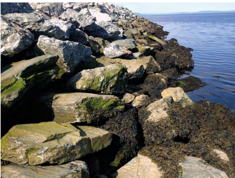
Figur 8-17 Eksempel på plastring som skal korrigeres: frittliggende blokker, store hull, blokker som peker nedover og blokker med dårlig form. (Værnes. Foto: Norconsult).
