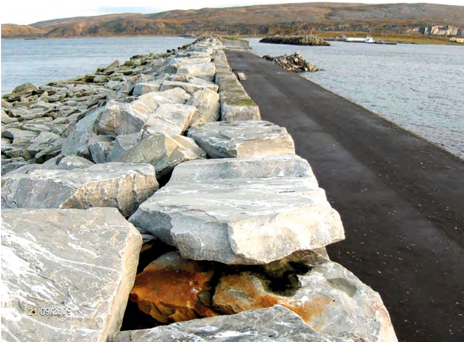
Figur 7-12 Utforming av brystvern i meget utsatt molo (skuldermolo). Brystvernet består av bare blokker nærmest, og betongmur i bakgrunnen. Foran brystvernet ligger 3-4 blokker som beskyttelse. (Berlevåg. Foto: Norconsult).
