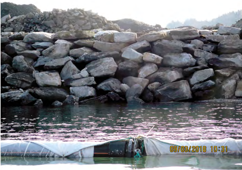
Figur 8-12 Eksempel på molo/fylling med «ordnet raus», se tabell 3-1. (Foto: Norconsult) Byggingen kvalifiserer ikke til Plastring fordi det er for mange små blokker, blokkene ligger med feil helning og mange blokker ligger uten støtte. SKAL IKKE BENYTTES I MOLOBYGGING.
