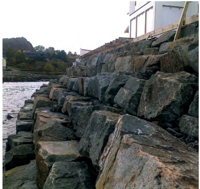
Figur 8-15 Hvis steinkvaliteten og formen tilsier det, kan man godt lage en trappefront i stedet for en jevn overflate. Merk at blokkene i dette tilfellet er svært lange, slik at en blokk fortsatt gir støtte til blokka ovenfor. (Kabelvåg. Foto: Norconsult).
