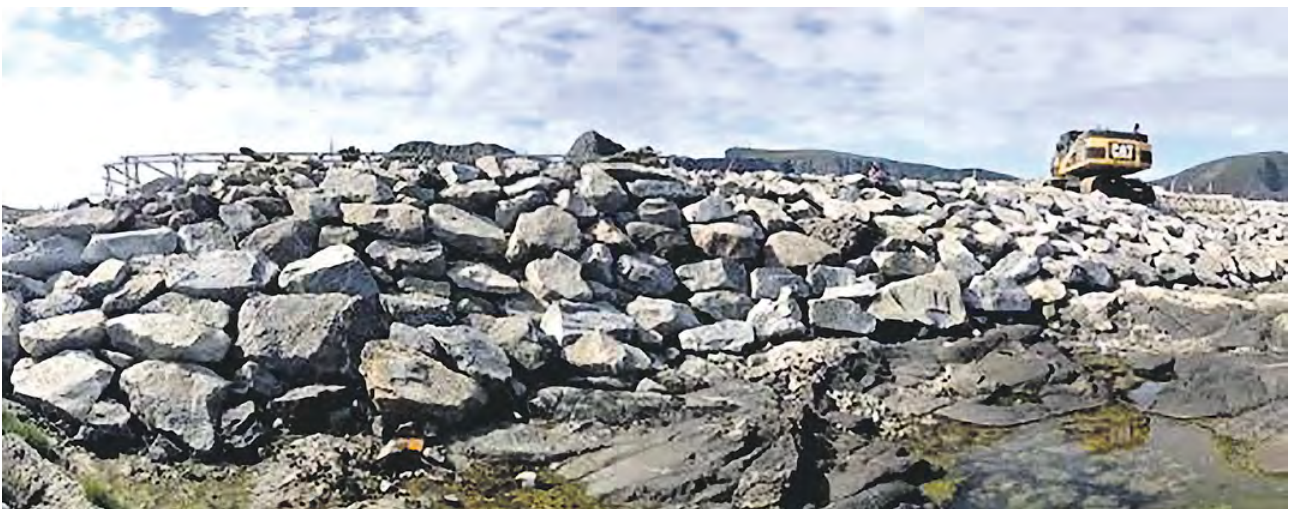
Figur 8-20 Eksempel på plastring som har lav motstandsevne mot høye bølger (men kan være OK på mindre utsatte steder): blokkene ligger med feil orientering, dvs med flatsiden inn mot moloen. I dette tilfellet er plastringen heller ikke utført nedenfra og opp, og de fleste blokkene ligger fritt uten støtte. (Værøy. Foto: Norconsult).
