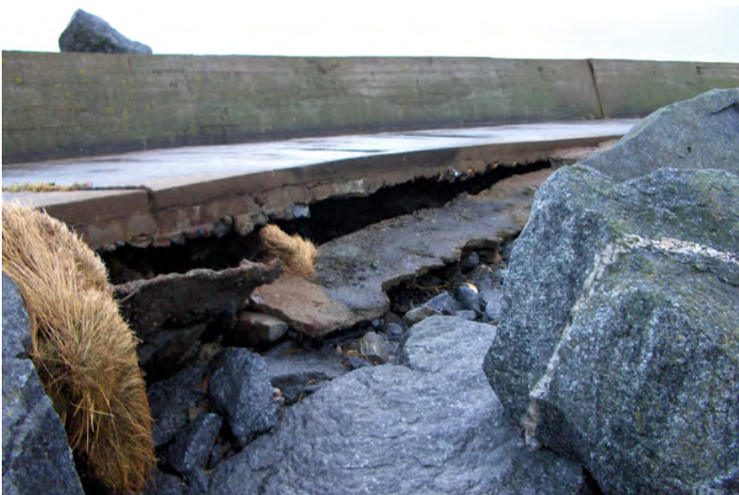
Figur 8-23 Skader under dekket og på baksiden etter overskylling og gjennomskylling av høye bølger. Den konvekse formen på dekket og en solid betongfront bidrar til å bevare formen på dekket og hindrer totalt sammenbrudd. (Tynnesmoloen, Værøy. Foto: Kystverket).
