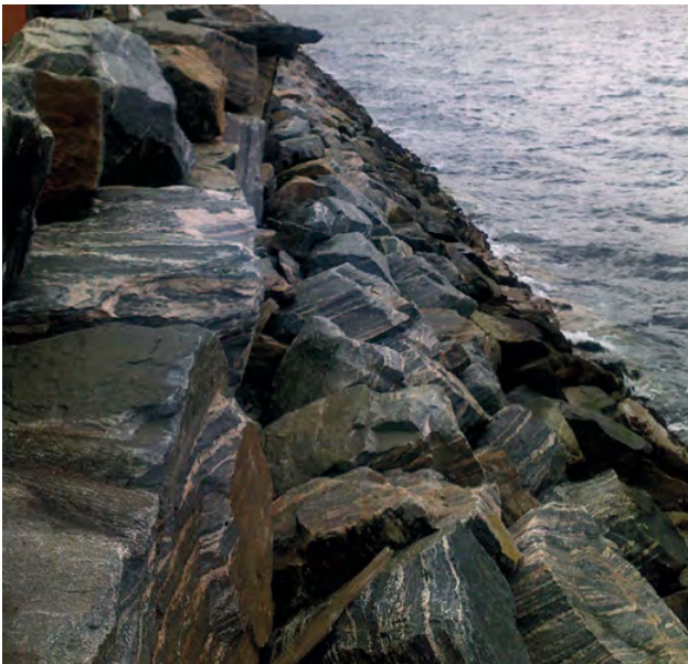
Figur 8-14 Eksempel på godt utført plastring i skjermet farvann: Blokkene ligger med god vinkel og er godt låst til hverandre. Dette er akseptabel metode for skjermede farvann, der bølgene er moderate. For mer utsatte farvann ville man foretrekke en litt mer ru overflate med større ujevnheter. Brystvernet øverst består av frittliggende blokker som ikke er sikret, noe som er akseptabelt her. (Vikan, Kristiansund). (Foto: Norconsult).
