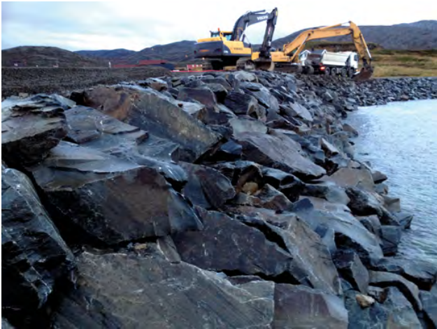
Figur 8-19 Eksempel på plastring som må korrigeres: Blokkene ligger til dels løst på overflaten uten støtte, og blokkene ligger med helning utover (peker nedover). (Mehamn. Foto: Norconsult).
