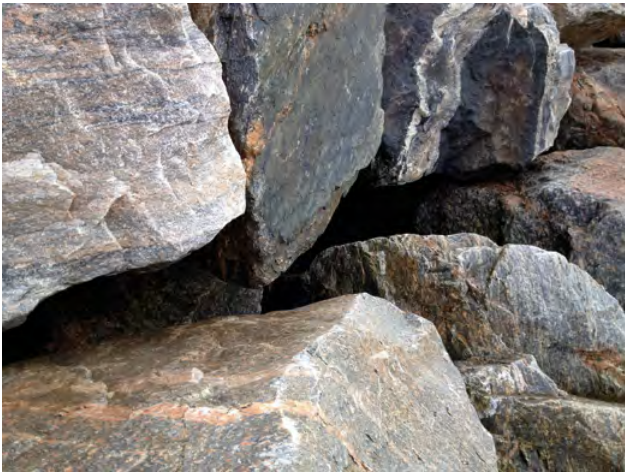
Figur 8-18 Eksempel på svikt i underlaget, Moloen/fyllingen er lagt på utfylte masser, og setninger og sig i underlaget fører til at de øverste blokkene blir hengende uten god understøttelse. Samtidig forsvinner låsingen som de overliggende blokkene skulle gi til blokkene under. (Molde. Foto: Norconsult).
