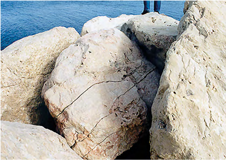
Figur 8-8 Oppsprekking av blokker er normalt ikke noe stort problem i Norge, så lenge blokkene behandles slik at eventuelle sprekker kommer fram før utlegging. I andre land er imidlertid holdbarheten av blokkene (oppsprekking, avskalling) et stort problem. (Gabes, Tunisia. Foto: Norconsult).
