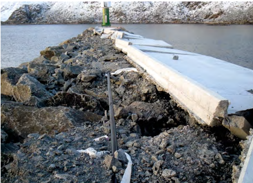
Figur 8-22 Eksempel på manglende integrering av dekke og molo, der brystvernet også mangler. Dekket er støpt som en frittliggende plate uten beskyttelse av brystvern, og dekket ligger på tilnærmet tette masser. Under sterk bølgepågang med overskylling presser sjøen på framkanten, og betongplatene løftes av det indre vanntrykket pga dårlig drenering. Merk at moloen ellers er uskadet. (Stamsund. Foto: Norconsult).
