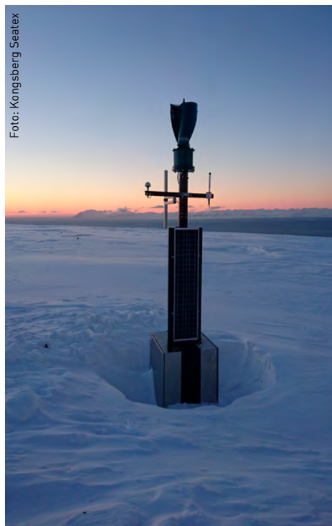
Test av AIS-basestasjon på Svalbard.
