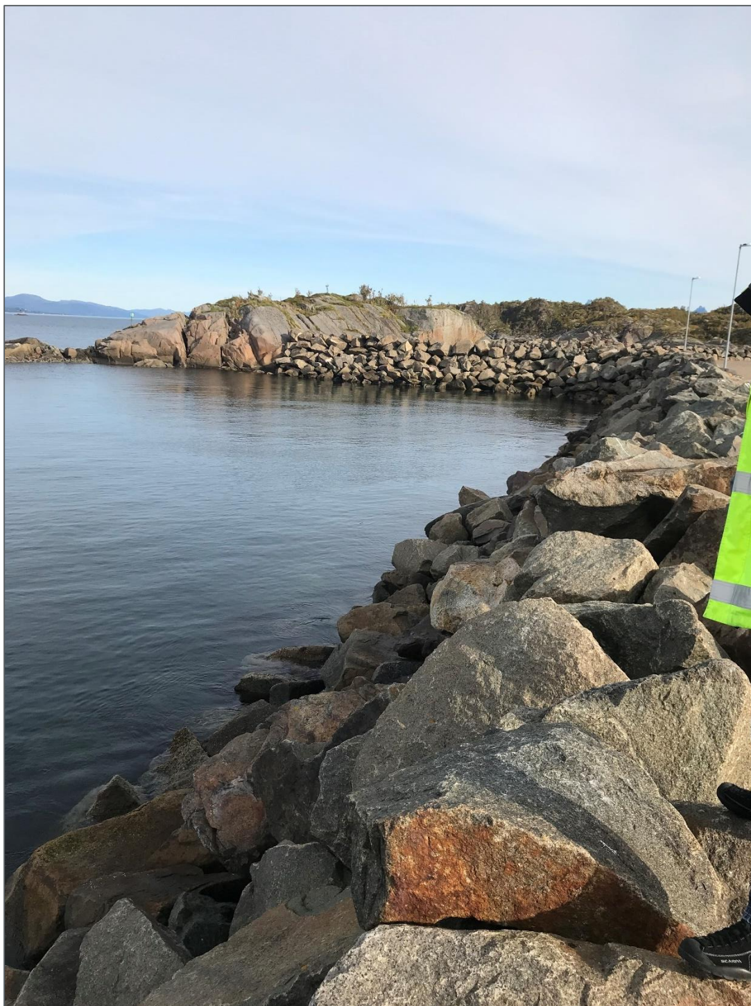
Figur 6 Fra eksisterende molo 2021-09-16. Inspeksjon viser at moloen er for lav og ikke tilstrekkelig plastret til å tilfredsstille krav til sikkerhet ved permanente arbeidsplasser.
