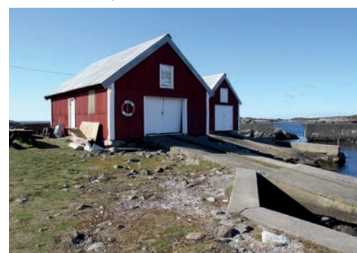
Under: Fasadehjørne mot nordøst.
