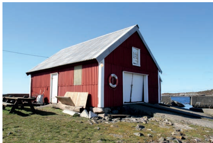
Under: fasadehjørne mot nordøst.
