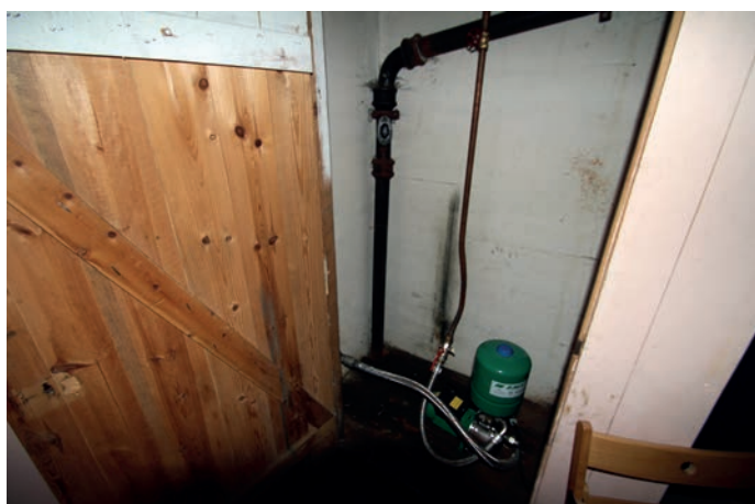
Under: Pumpe i kjeller.
