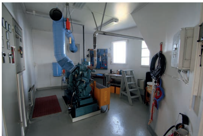
Under: Fra maskinrommet i 1. etasje.
