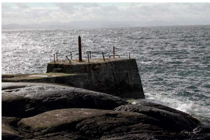
Landingen, med rest av kranfundament og rekkverk.
