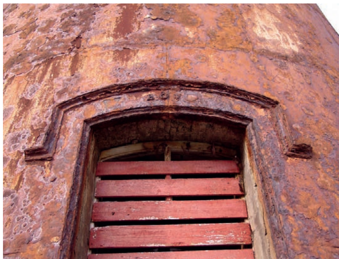
Under og t.h.: Inngangen sett fra ulike vinkler. Studie av rust.
