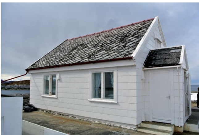
Over: Fasade mot øst. Merker etter tidl. trapper.
