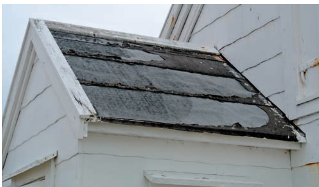
Taket over inngang trenger ny papptekking.
