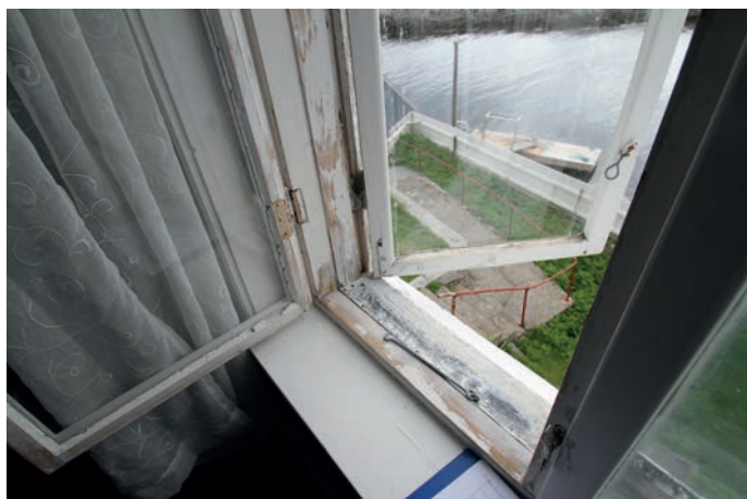
Under: Vindu med varevindu i 1. etasje.
