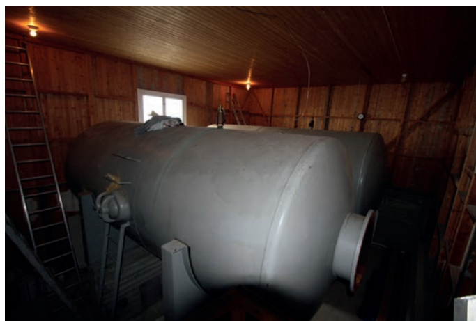
Over: Lufttanker i eget tilbygg.
