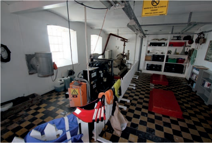
Over: Maskinrommet, sett fra inngangen.
