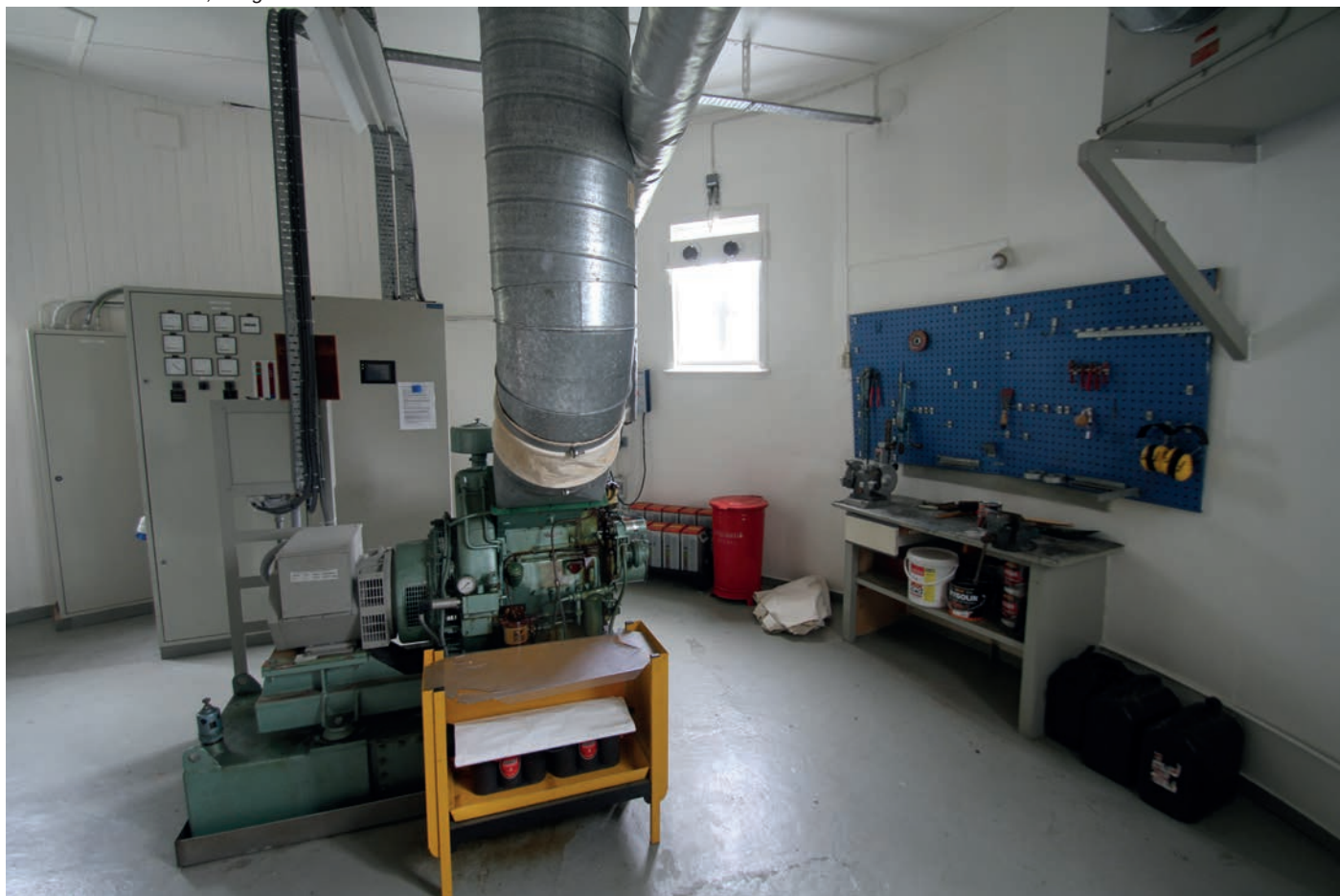
Under: Maskinrommet, 1 etg. i tårnet.
