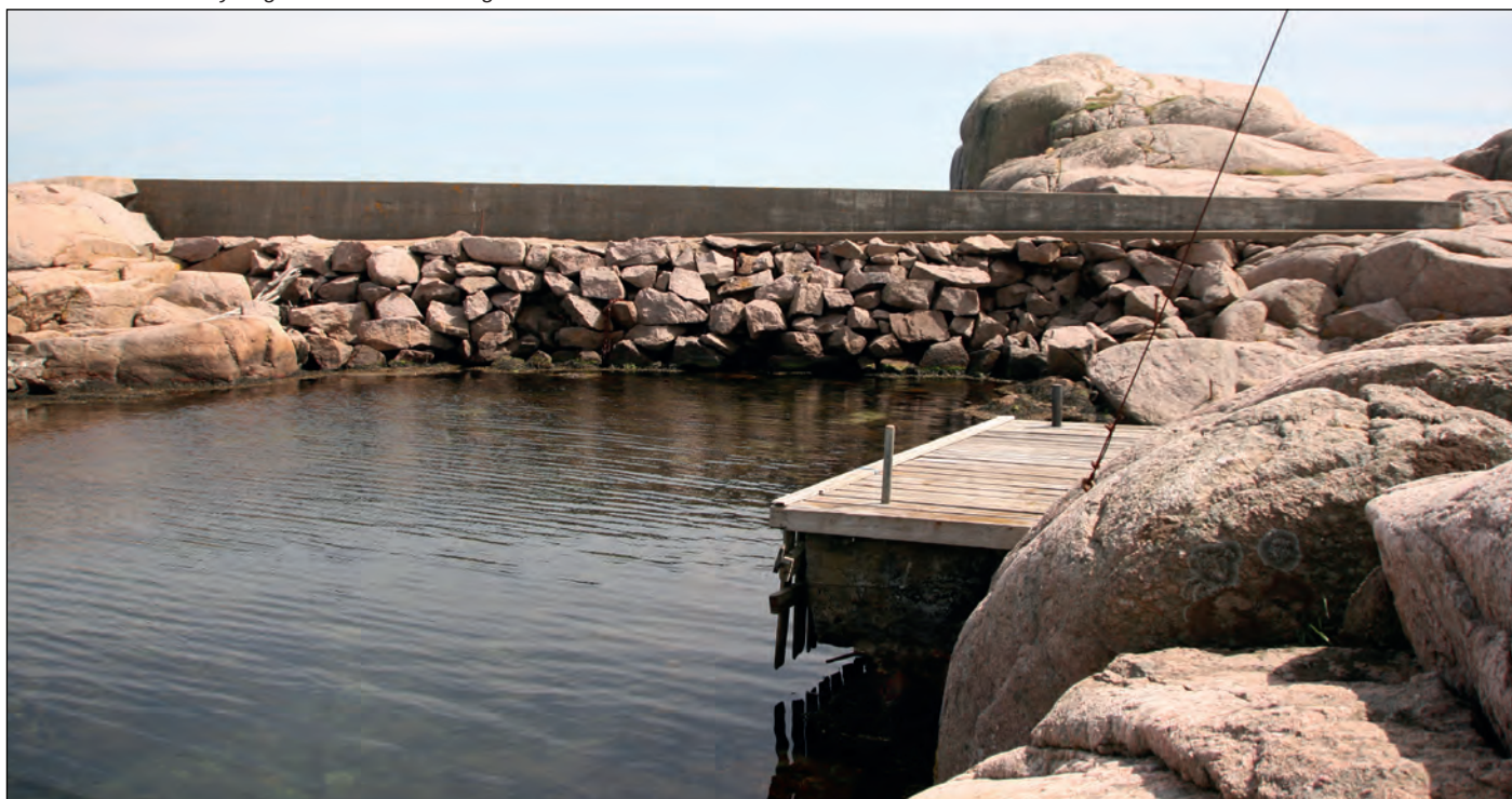
Under: Moloen mot syd og øst. Større utbedringsarbeider ventes utført i årene fremover.
