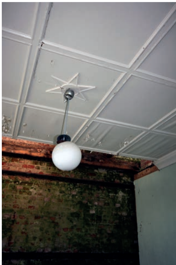
Over: Himling og takbelistning i rom 1-103, 1. betjents soverom. Under: Tidligere fyrmesters soverom, nå ribbet for innvendig kledning.
