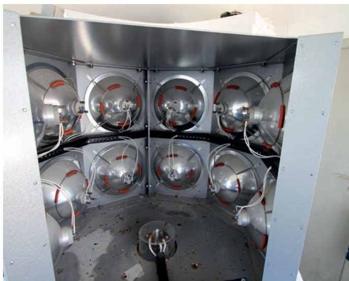
T.v.: Lyskilden i fyrlykta. Sett inn fra baksiden.
